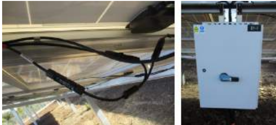
Illustration 66: Exemple de câble électrique et de boîte de raccordement
